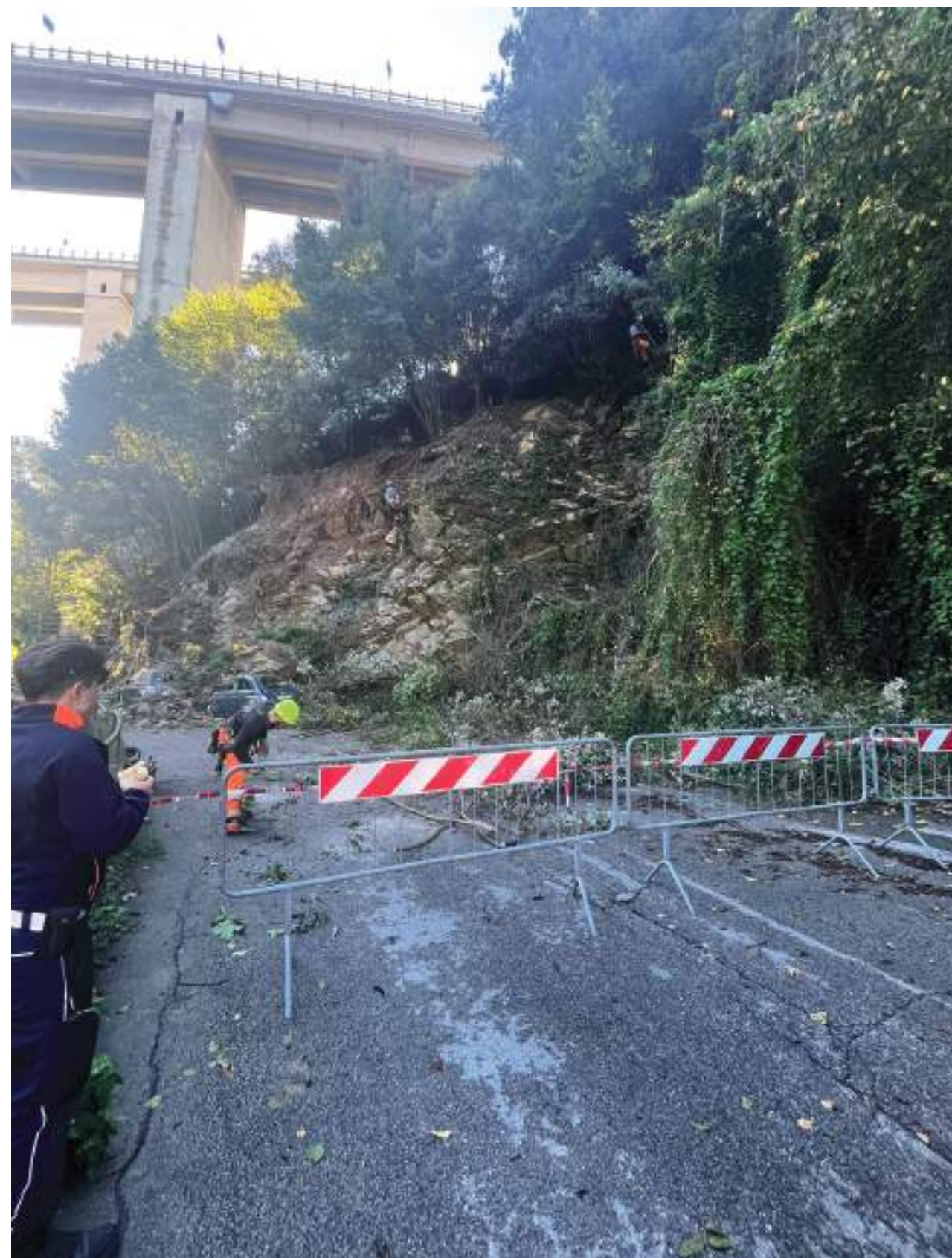
Interruzione strada a seguito della frana.
